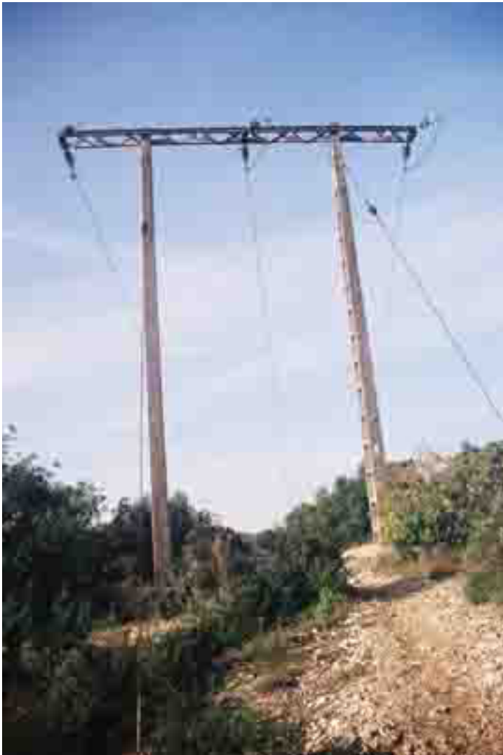
2 exemples de lignes pouvant s'avérer dangereuses pour l'avifaune (photos COGard)
